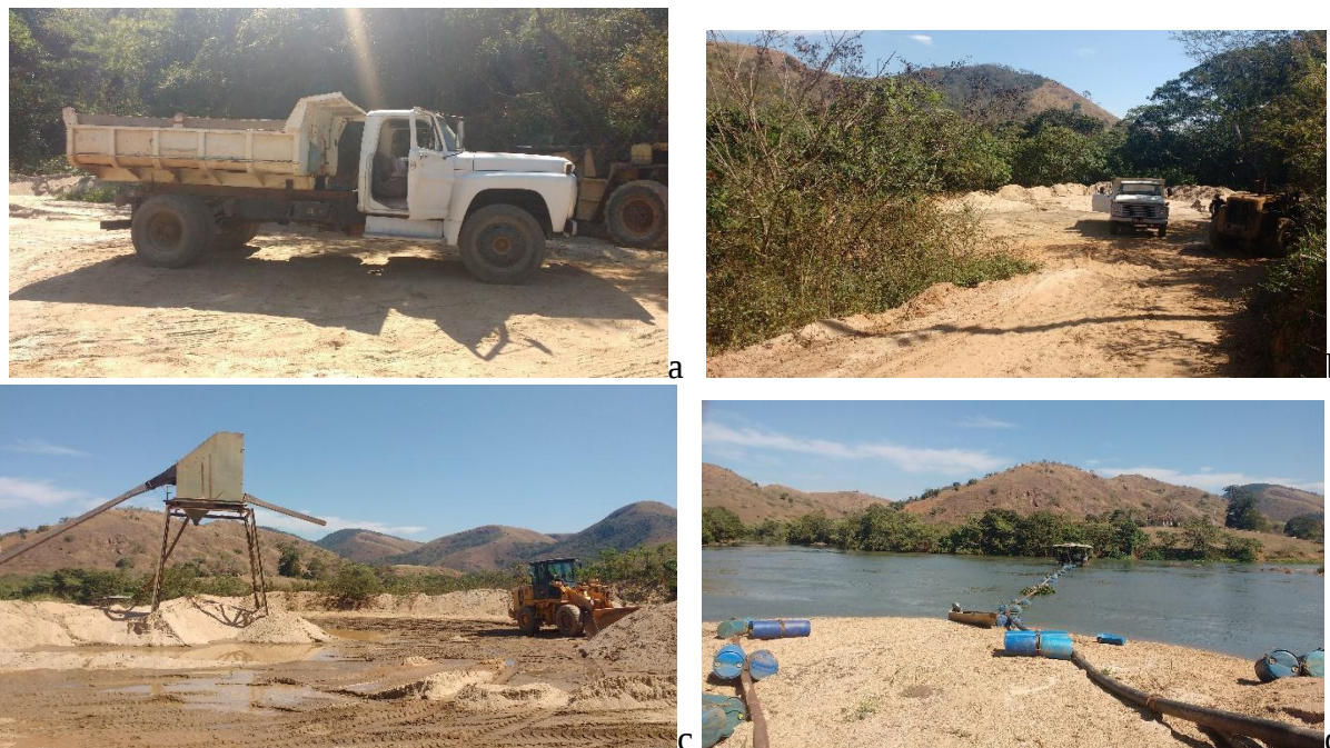
Figura: Atividades de extração mineral ilegal no leito do rio Paraíba do Sul, nas localidades de Lacerda, Valença (fotos a e b) e Abarracamento, Paraíba do Sul (fotos c e d)
